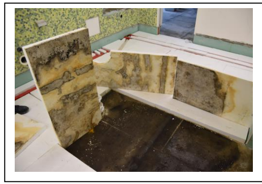
Abbildung: Estrichdämmschicht, mikrobieller Befall durch länger einwirkende Feuchtigkeit. Eine Trocknung der Fußbodenkonstruktion ist nicht sinnvoll. Es ist ein Rückbau erforderlich Quelle: Robert Kussauer
