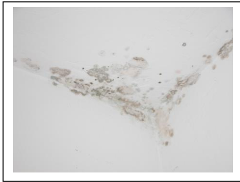
Abbildung: Kondensationsschaden durch Wärmebrücke Quelle: Robert Kussauer
