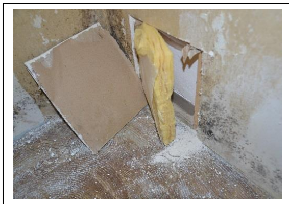
Abb. Schimmelschaden an einer Innendämmung Quelle: Robert Kussauer
