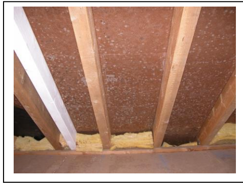
Abbildung: Mit Schimmelpilzen befallene Dach-Unterdeckplatten Quelle: Robert Kussauer
