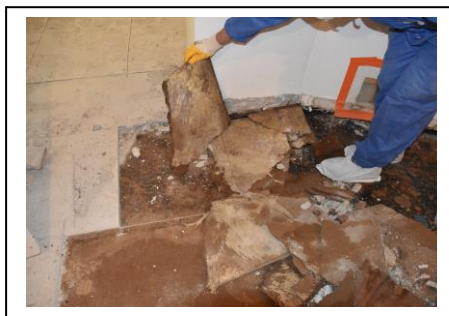
Abb. 1 Großer mikrobieller Schaden Quelle: Robert Kussauer
