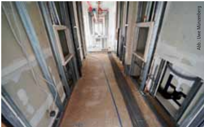
Abb. 2: Beispiel für die Komplexität moderner Bauweise: hier lassen sich luftdichte Abschottungsmaßnahmen nur schwerlich umsetzen.
