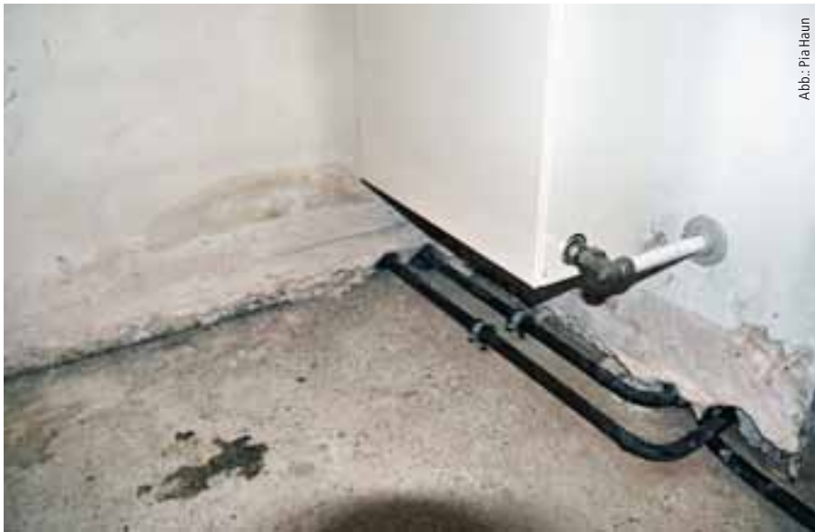
Abb. 4: Um Schimmelschäden in Fußböden abzuschotten, muss in der Bestandsaufnahme ermittelt werden, ob und wo es beispielsweise Wand- oder Deckendurchbrüche gibt.
